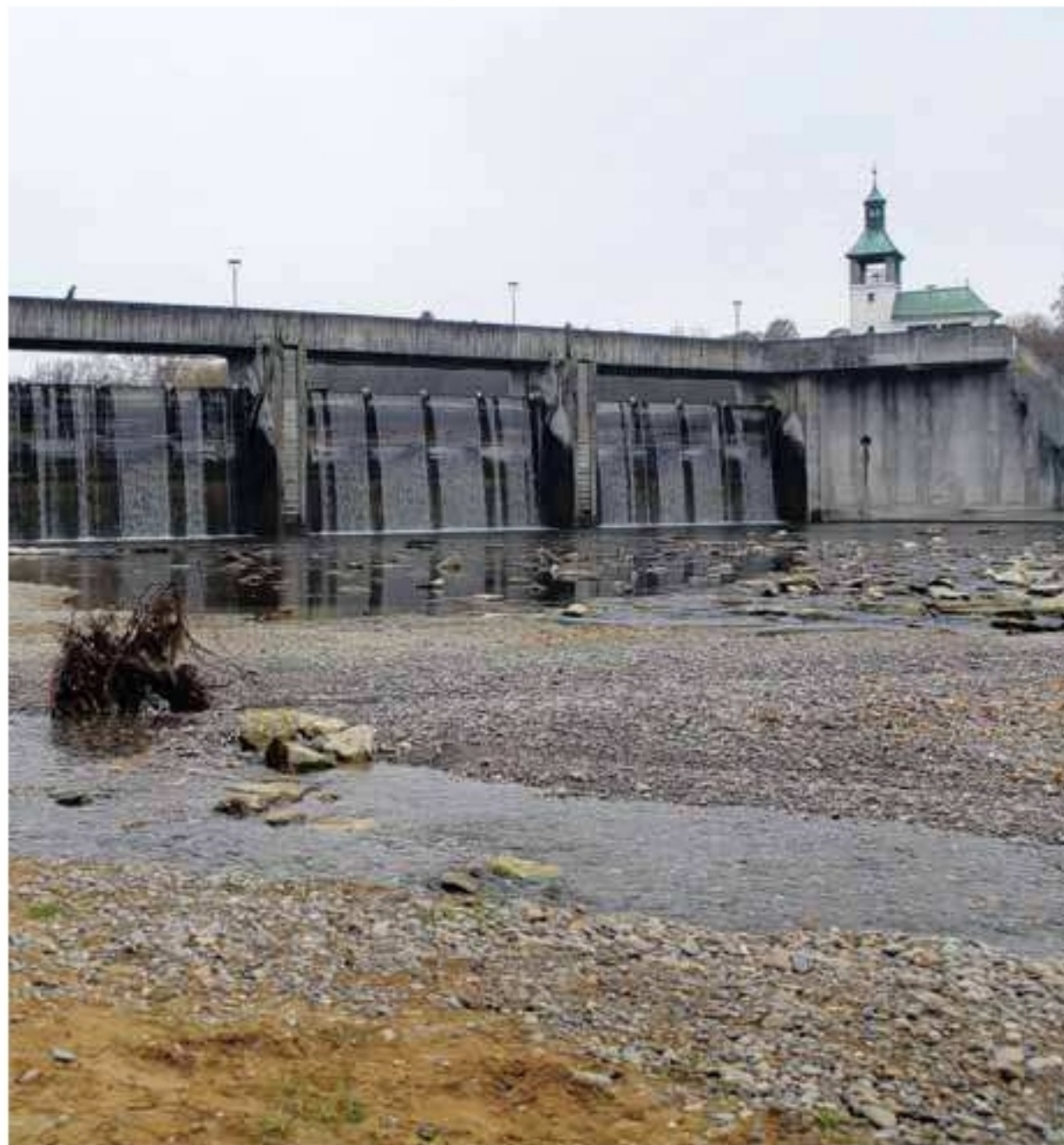
Das geplante Wasserkraftwerk könnte den Hochablass trockenlegen. Über die Wehrmauer beziehungsweise die Wehrfelder (wie in den drei Bereichen rechts) würde dann kein Wasser mehr fließen, es ginge durch die Turbinen. Foto: Michael Hochgemuth
